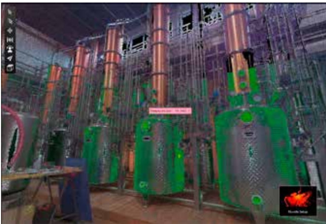
Ricostruzione interno di impianto industriale: sovrapposizione di immagini RGB, 3D e termiche
